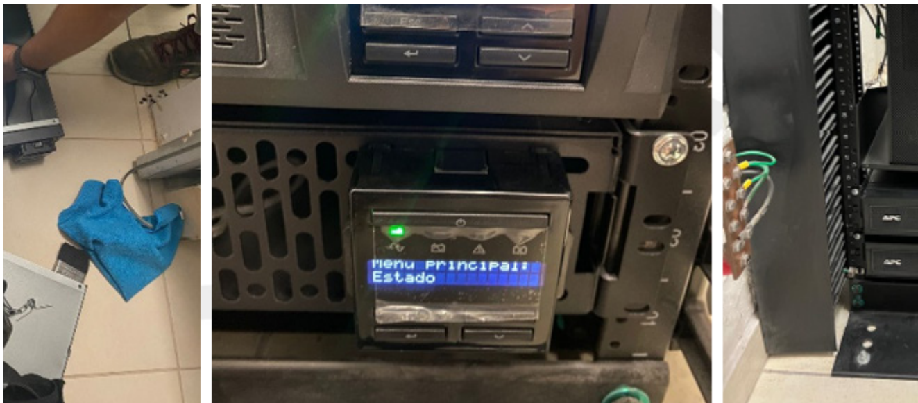
Mantenimiento realizado a los UPS de la SESAJ.
